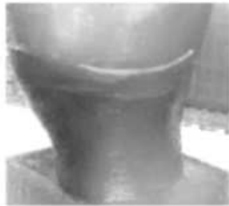
a) Escurrimientos de material
