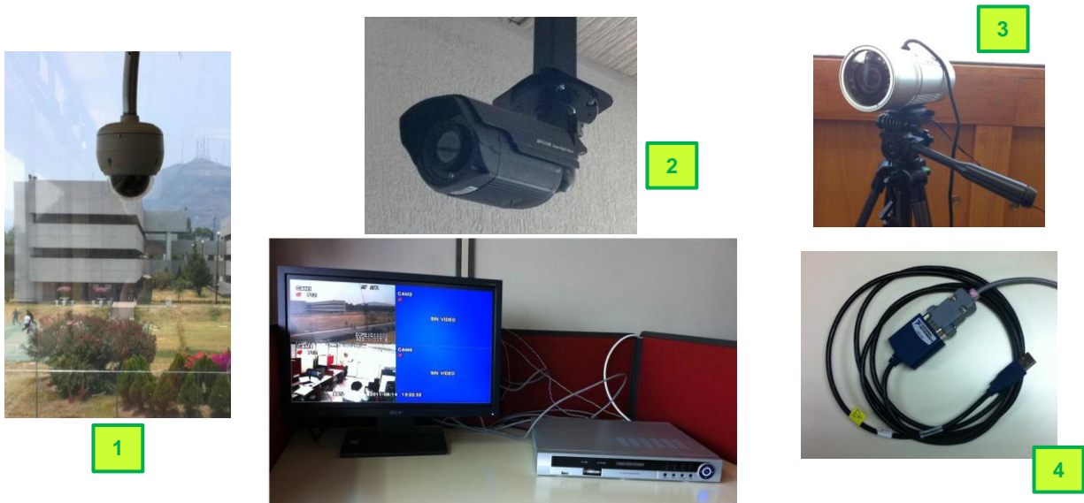
Figura 6.1 Sistema de videovigilancia instalado
